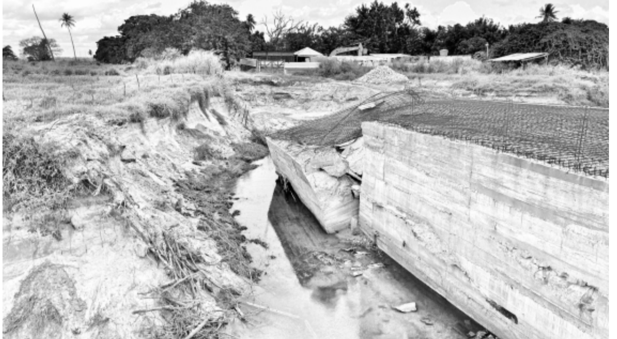
Chuvas fizeram base das obras erodir e construção cedeu. Quem pagará pelo prejuízo milionário?
